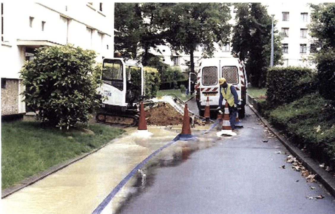
Fuite sur canalisation sur voie privée
