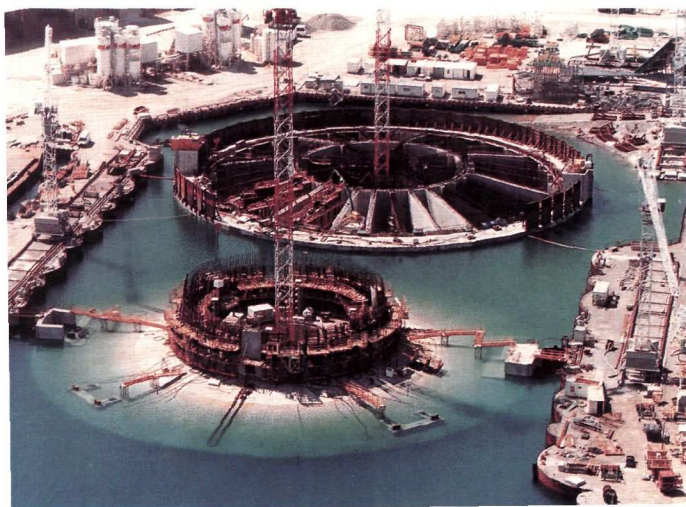
Fig. 2 - Deux fondations de 90 m de diamètre. Celle de devant est en flottaison.
