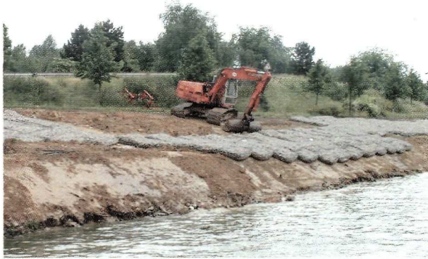
Pose d'un matelas sur les berges de la Deûle à Lille ; les travaux du contrat précédent (calibrage à 1 350 t) ont anticipé la mise aux 3 000 t : ainsi, les berges ne seront pas à reprendre.
