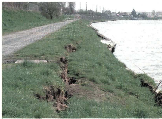
Déversement d'un rideau sur les berges du canal à grand gabarit près d'Arleux.
