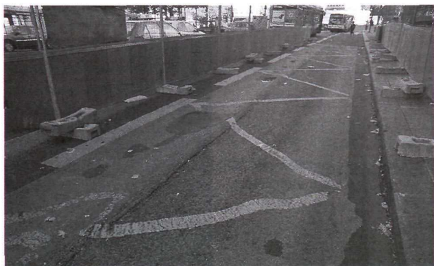
Orniérage de l'enrobé sur l'arrêt de bus Rue de Lyon à Paris 12 e .
