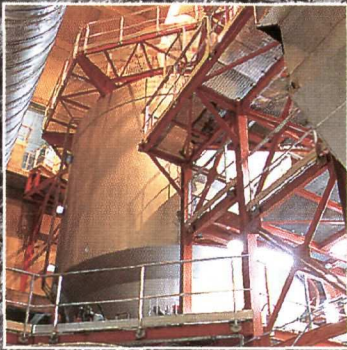
Four d'incinération des boues Pyrofluid
