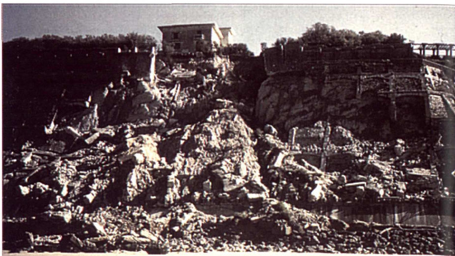
Dégradation des falaises de Biarritz 1978.
