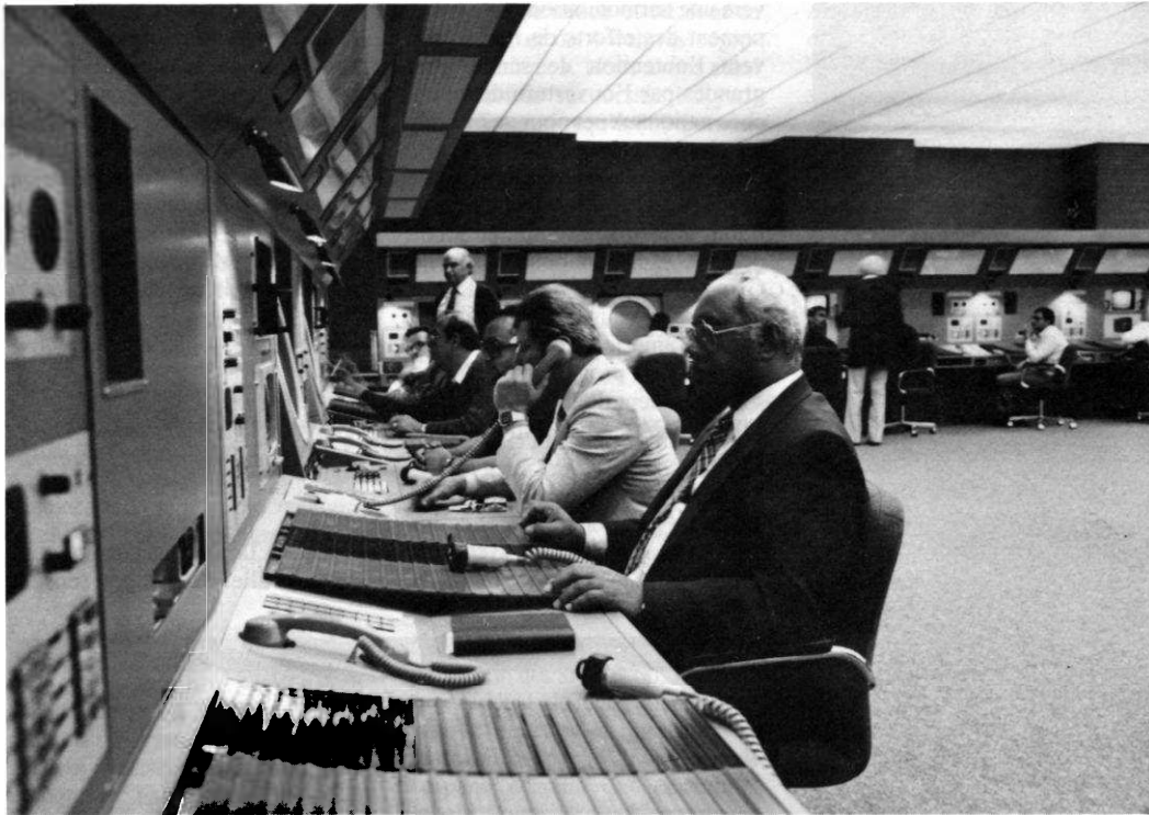
Salle du centre de contrôle du trafic aérien du Caire équipée par Thomson-CSF.
