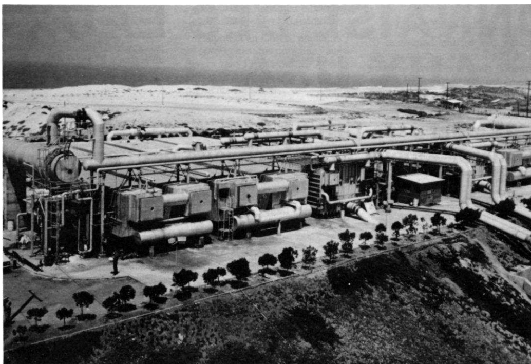
Aqua-Chem — Côte Pacifique, Mexique. Unité de dessalement d'eau de mer par évaporation flash. Capacité : 35 000 m 3 /jour d'eau potable.
