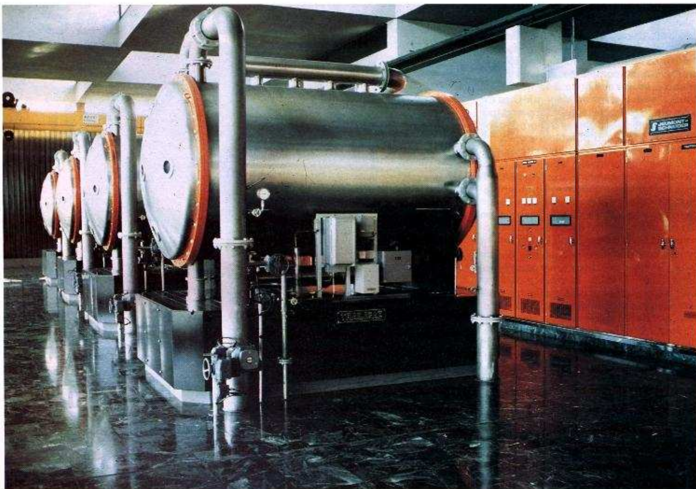
Les quatre ozoneurs de l'usine de Neuilly-sur-Marne sont parmi les plus performants construits à ce jour : production totale 2 880 kg/j. (Doc.SCBPE).
