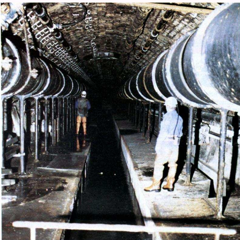
Conduites d'eau en égouts
