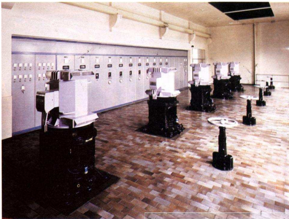
Salle des pompes de refoulement
