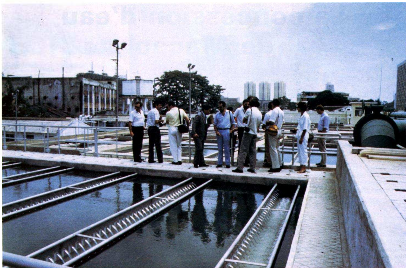
Les décanteurs (lamellaires)
