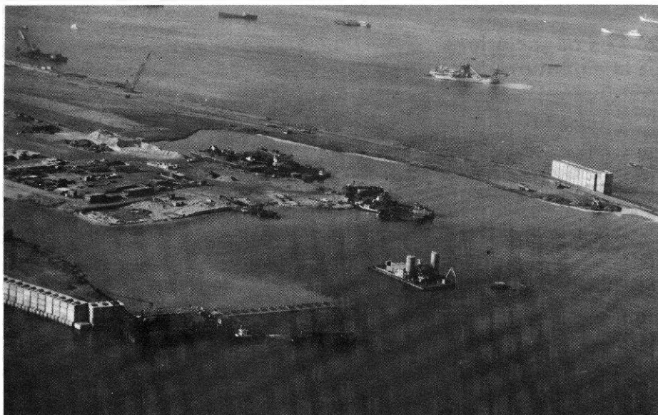
L'extrémité Nord du môle en cours de construction montrant les blocs du mur de quai et leur préchargement.
