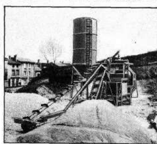
Petites centrales de chantier 10 à 30 m 3 /h. Bétonnière ou malaxeur, alimentation des agrégats par rayon raclant ou dragline.
