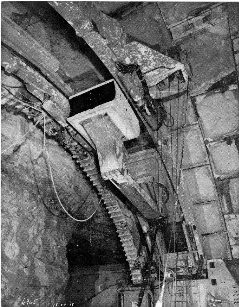
Fig. n° 6. — Lot 3b. Début de mise en place d'anneau de voûte. (Photo Saint-Bernard).
