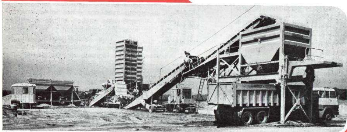
Centrale mobile 1000 tonnes/heure
