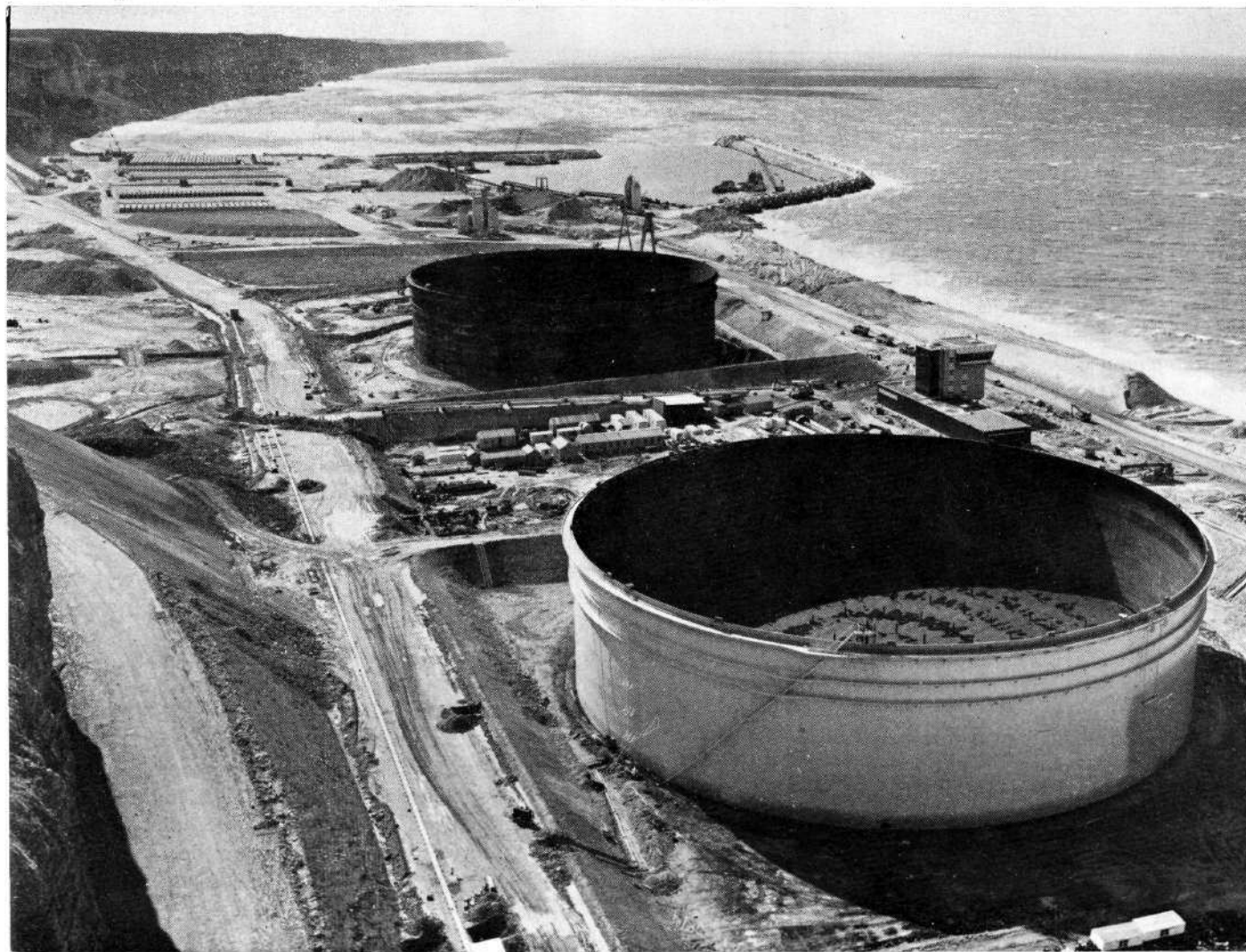
Vue du terre-plein avec les bacs de stockage. A l'arrière plan le port de service.
