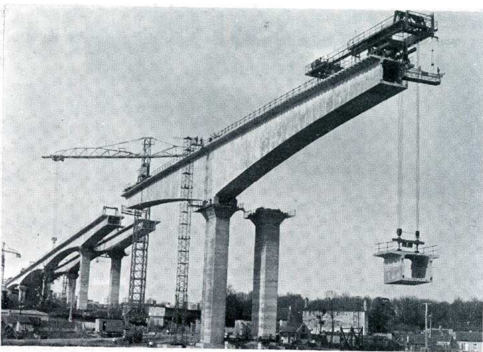
Pont de Calix à Hérouville-St-Clair. Record du monde de portée des ponts en encorbellement avec voussoirs préfabriqués (156 m).
