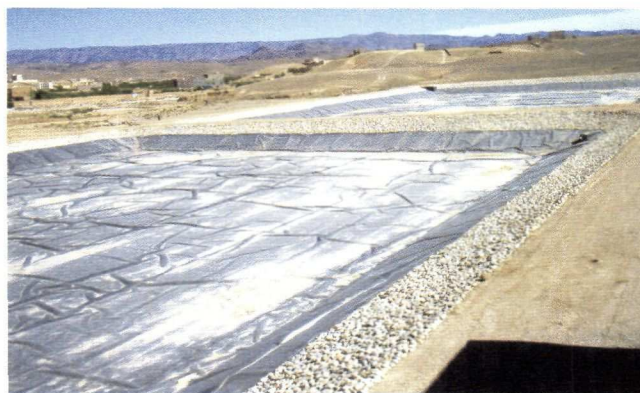
Station du traitement des eaux
