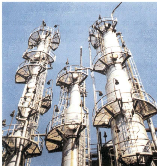
Usine Motor Oil Hella - Grèce (Technip).
