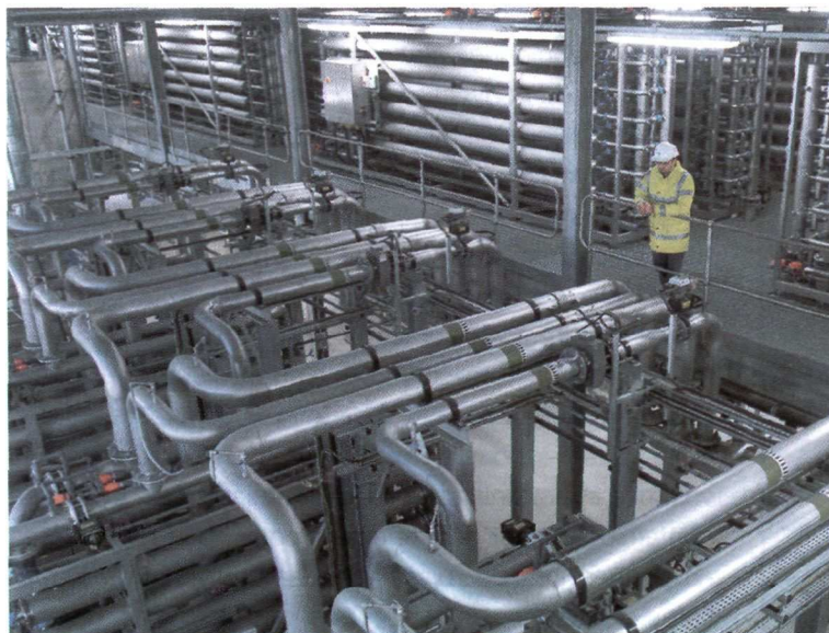
Usine de traitement d'eau potable par membrane (ultrafiltration) de Clay Lane (Angleterre).
