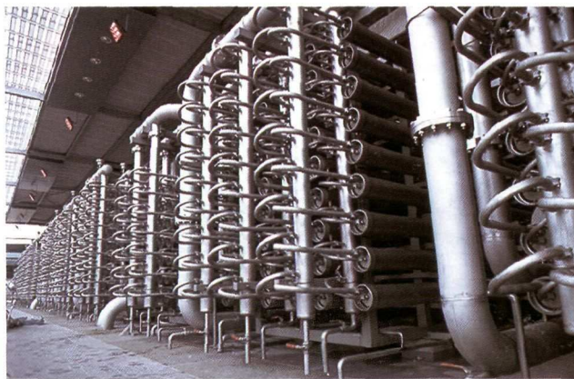
Usine de traitement de Méry-sur-Oise (Potabilisation d'eau par Nanofiltration) qui est un exemple de l'application des nouvelles technologies membranaires.
