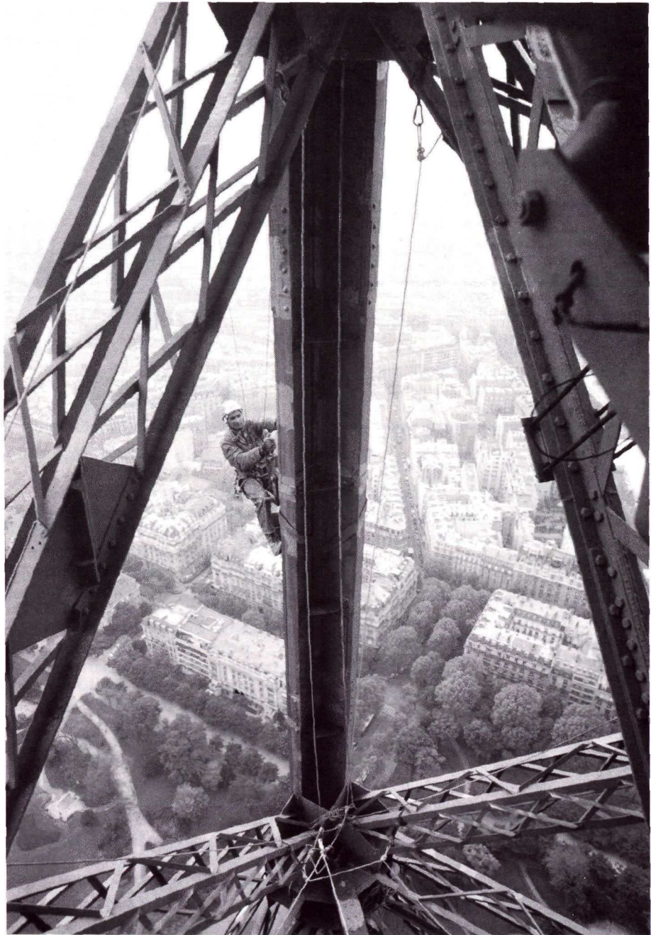
Protection anticorrosion par peintures : La Tour Eiffel.
