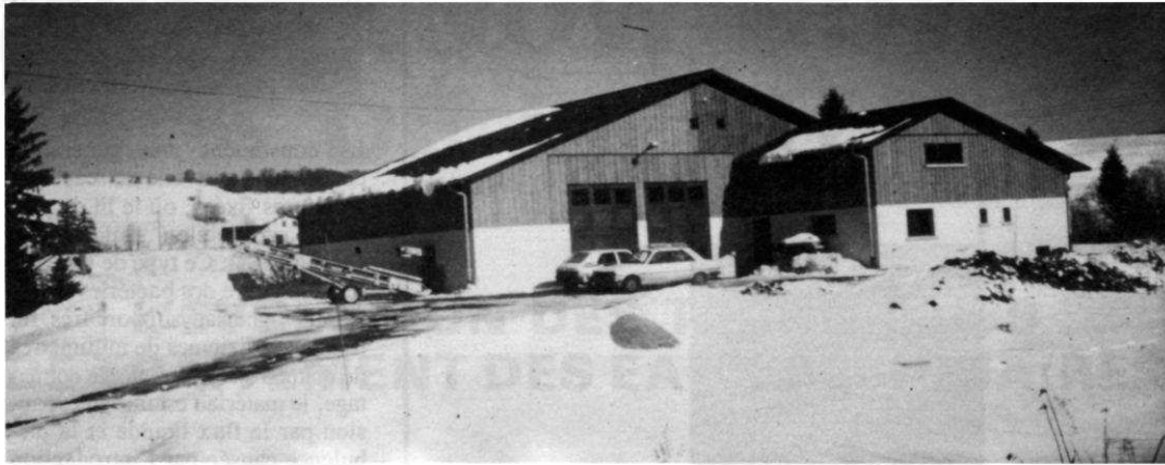
La station de Metabief dans le Jura. Mise en service pendant l'hiver 85-86. Elle traite avec un Biofor environ 3 000 m 3 /jour en pointe (15 000 habitants).
