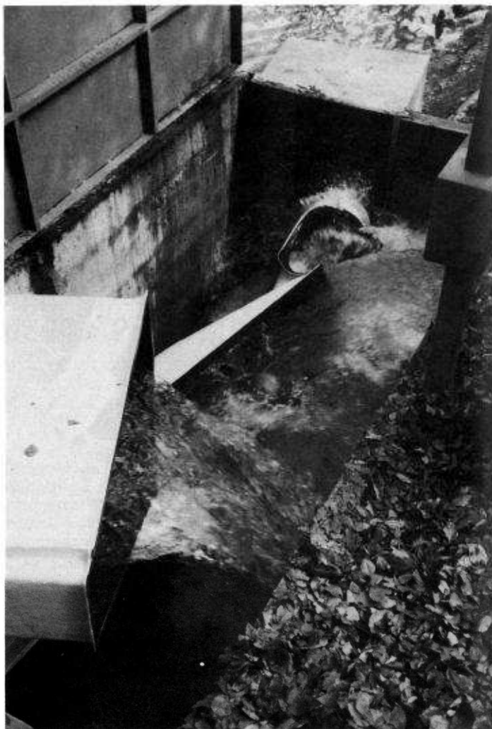
Le déversoir d'orage Filippi permet par un dimensionnement astucieux de limiter le débit maximal dirigé par la station d'épuration (cliché sade).
