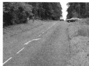
Marquage visible de jour.
