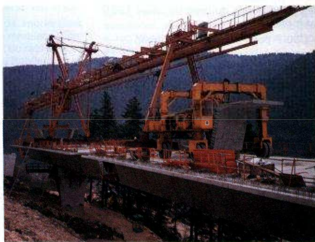
Fig. 17 - Viaduc des Neyrolles - Amenée d'un voussoir par fardier sous la poutre de lancement.
