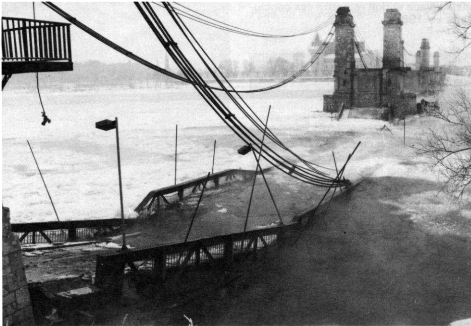
Photo de l'effondrement.
