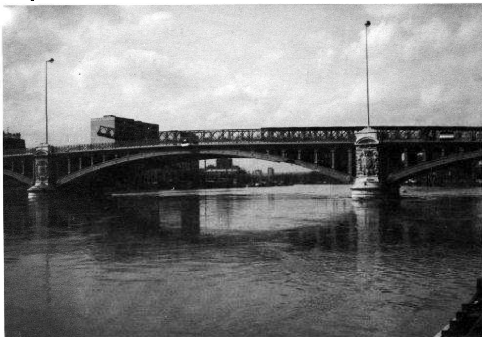
Vue générale de la travée accidentée.
