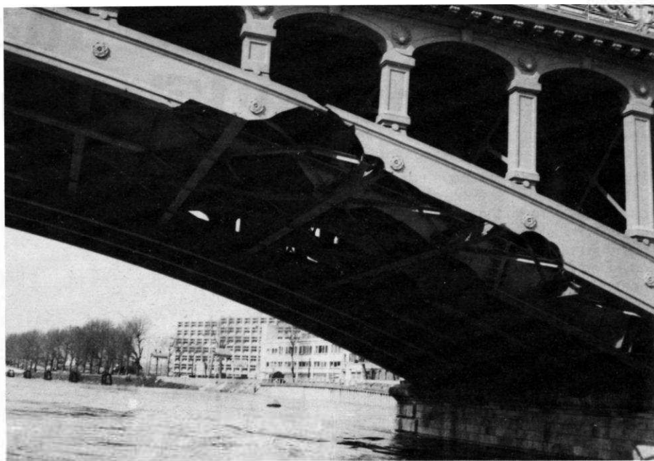
Désordre dans la travée 4 arcs fonte fracturés.
