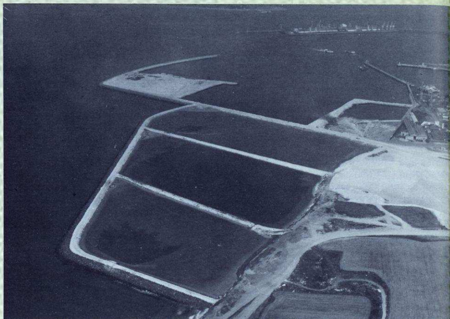
Vue sud-nord de l'extension. Au premier plan les 3 caisses de stockage des vases. C'est le casier nord qui est en cours de traitement pour consolidation.
