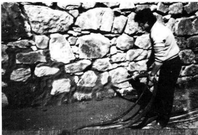
Rejointoiement mécanique profond adhérent par projection - voie sèche - d'un mortier de liant hydraulique. Notez l'arrivée séparée de l'eau (petit flexible) et du mélange des agrégats et du ciment à humidité naturelle (gros flexible).
