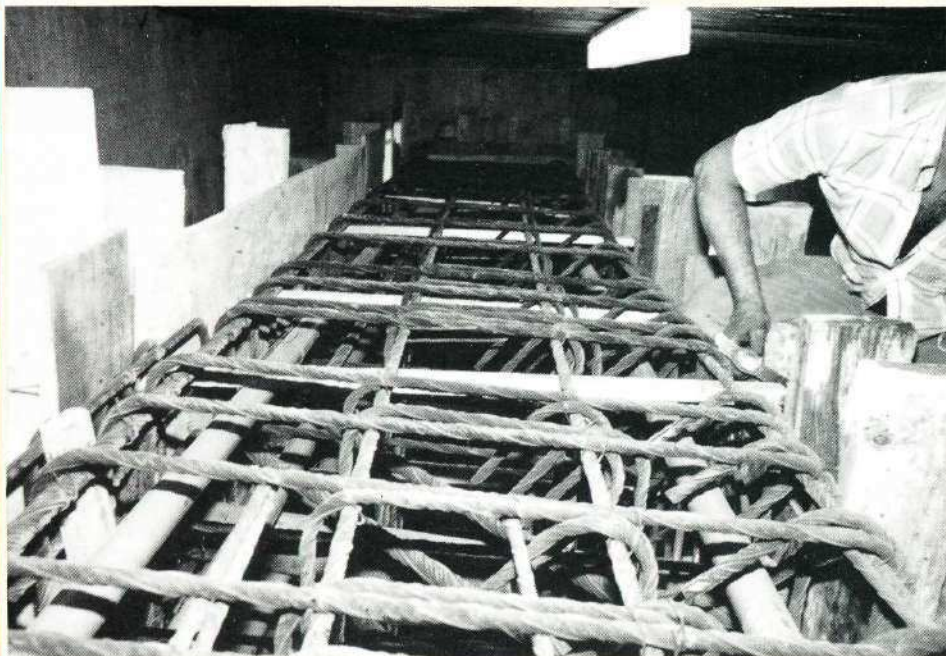
Ferrailage de la longrine d'appui des câbles 12.T.15 sur les tenons d'extrémité.
