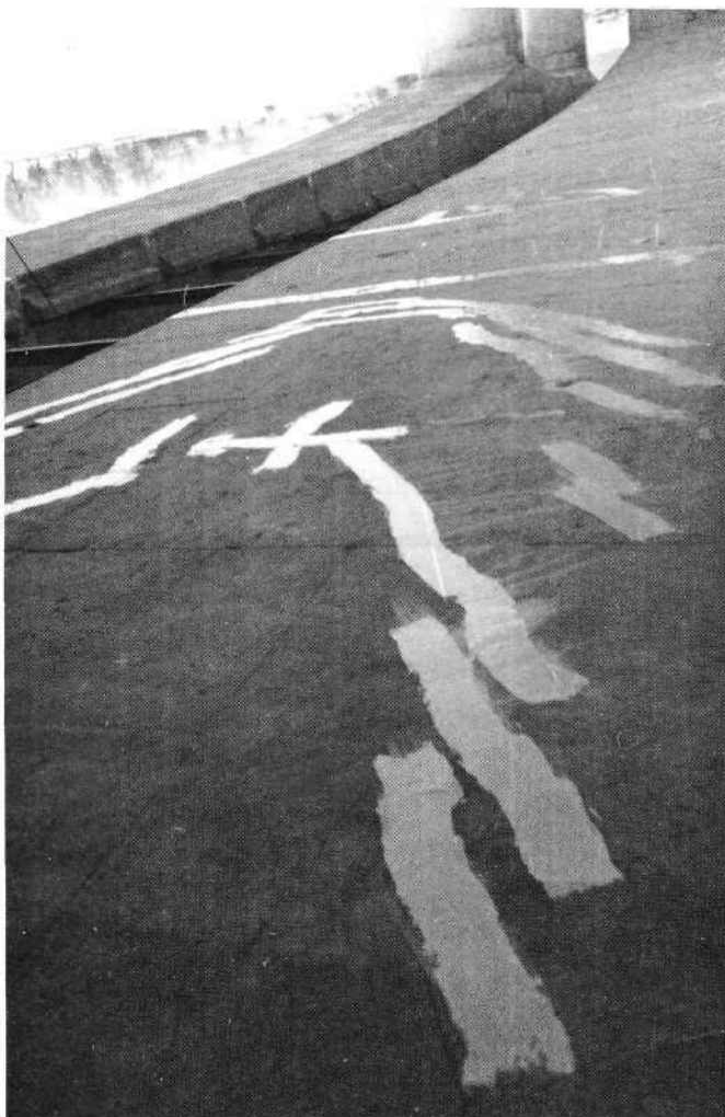
Fissure en hourdis inférieur.
