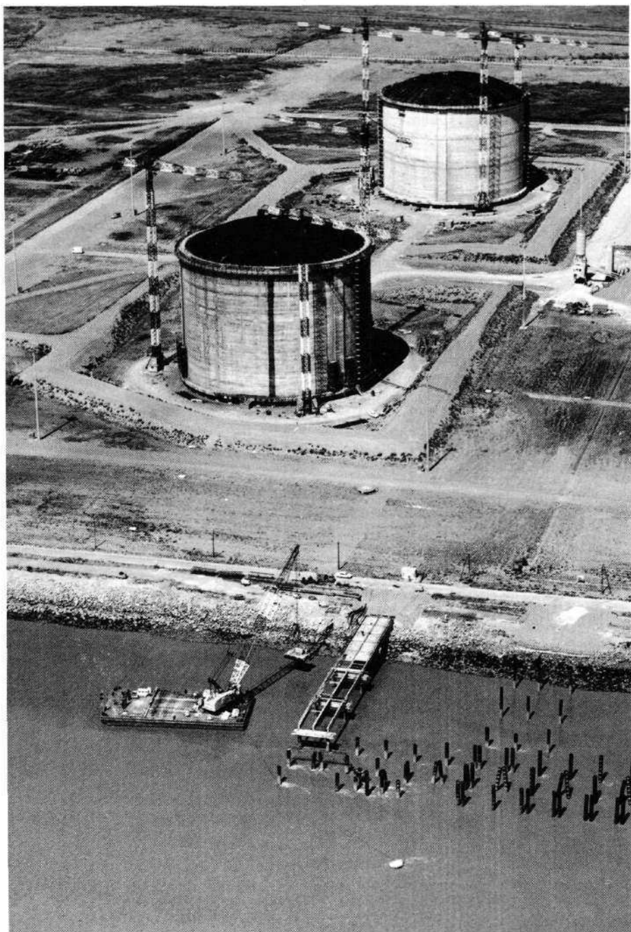
Vue des réservoirs et d'un appontement en construction - Photo Y. BLOND - Nantes.
