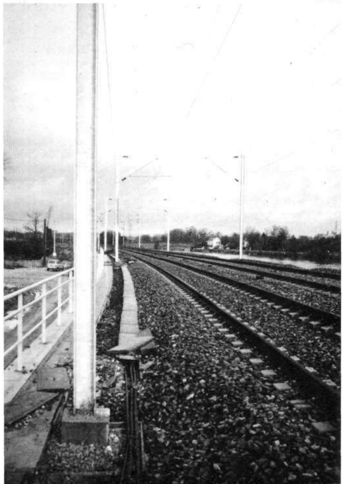
Fig. 7 - ligne électrique 25 KV - 50 H2.
