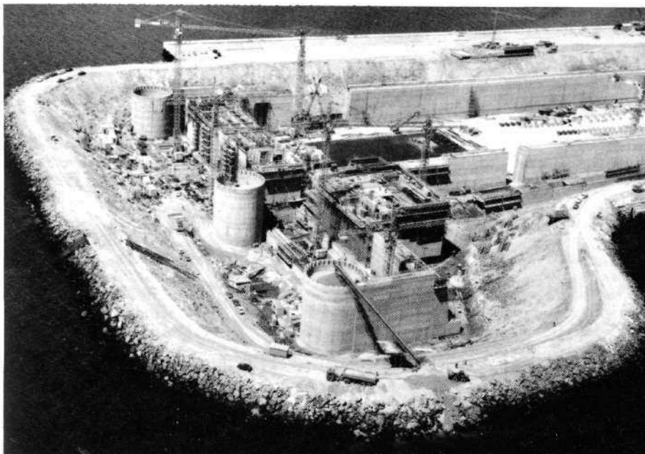
Fig. 4 — La partie avant de la forme et le batardeau qui va être levé à partir de septembre 1979. On voit les gabions protégeant le garage du bateau-porte et la structure alvéolaire de celui-ci. Sur la droite, le futur tunnel d'accès en fond de forme.
