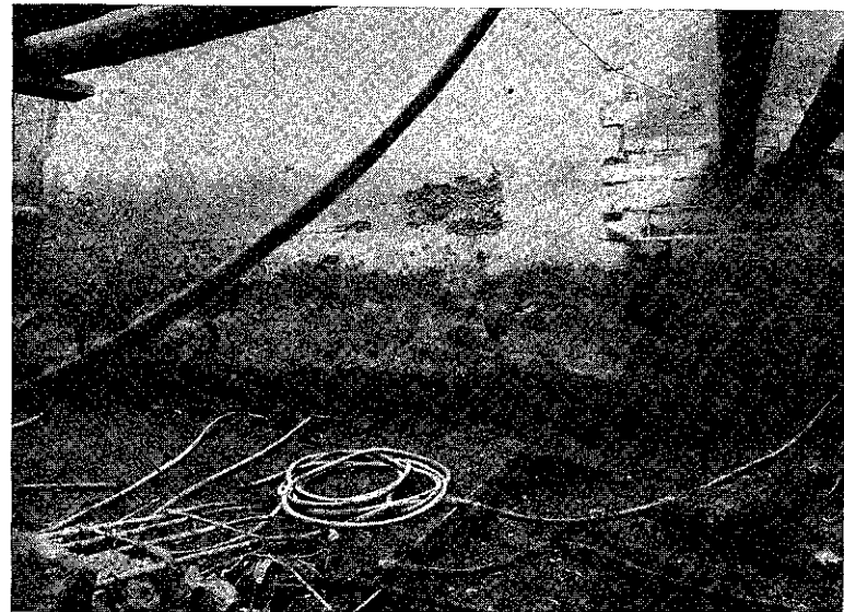
Fig. 9. — Etat de la pile rive droite avant redressement (Vu du parement rive gauche)
